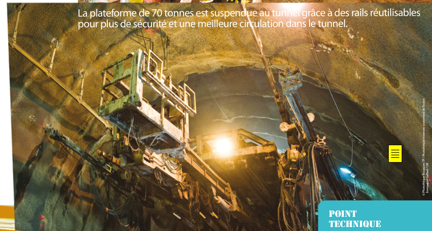
Pour limiter les délais de réalisation, le tunnel a été creusé sur deux fronts.
